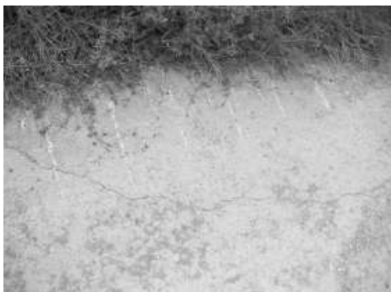
Εικόνα 14. Ρηγματώση στο άκρο του δρόμου
